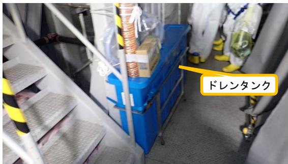
(写真3) ドレンタンクの設置状況
