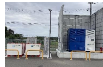
水素燃料電池の設置状況 於：TTK鹿島営業所（R5.9.27）
