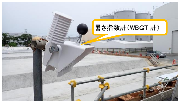
(写真3-1) 暑さ指数計(WBGT計)の設置状 況 (工事現場南側に設置)
