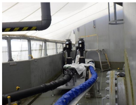
(写真3②) C群タンクの移送ポンプ
