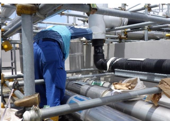
(写真2②) 移送ライン本体部分の配管からの漏えいがないことを確認
