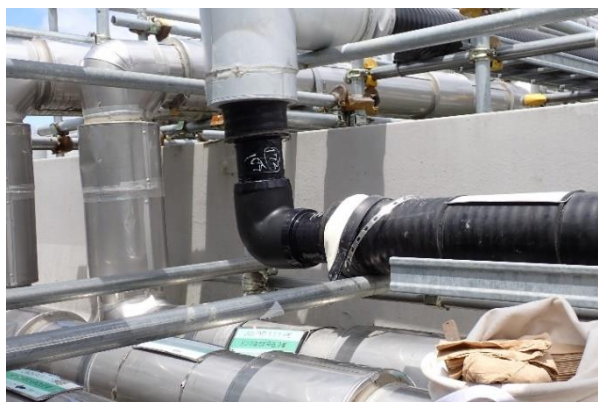
(写真2①) J1西タンクエリア北側の漏えい箇所 の保護材を剥がし、配管からの漏えい有無を確認
