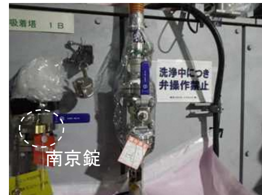
弁のロック状況写真（一例）
