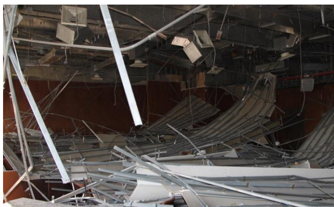
被災した役場庁舎（3階議場の状況）
