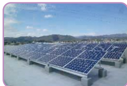
太陽光発電設備の導入
