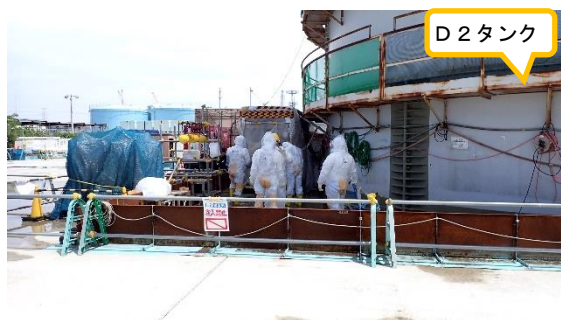
(写真2) タンク底板モルタル研り作業のため タンク内への入域準備をしている作 業員の状況
