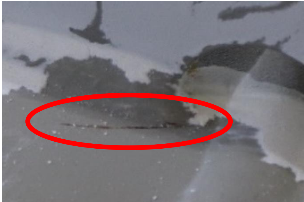
ブラケット溶接部のき裂
