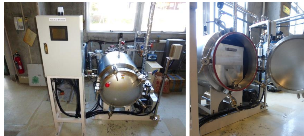
繊維熱処理装置 6/26落成検査合格
