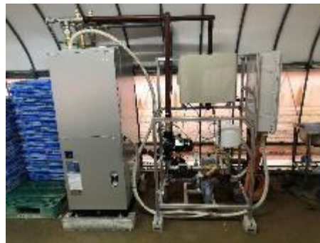
ヒートポンプ（熱出力30kW級）・機械室
