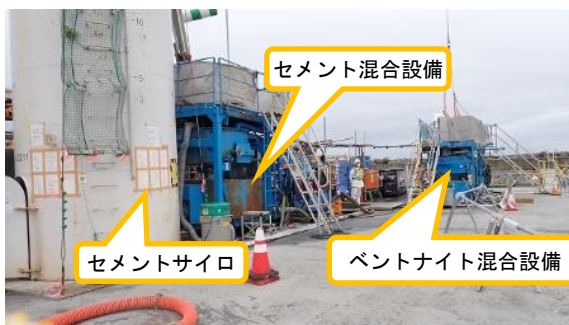
(写真 2 - 1) 被覆材調製プラントの概観
