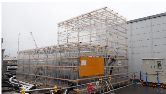
(写真5-1) フィルタユニットが設置されている 小屋
