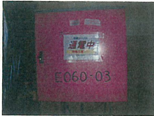
仮設分電盤 (プロセス主建屋2階)
