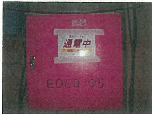
仮設分電盤 (焼却工作建屋1階)
