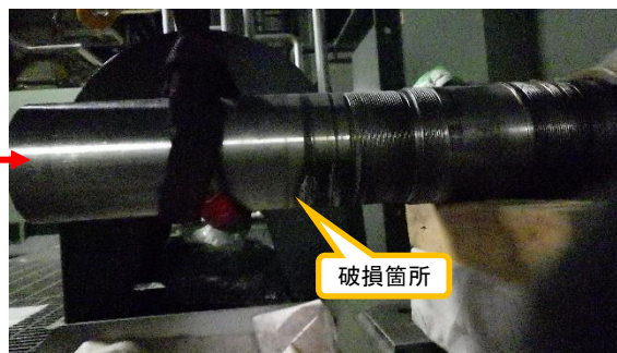
(写真1-2) 排風機 (A) のシャフトの状況②
