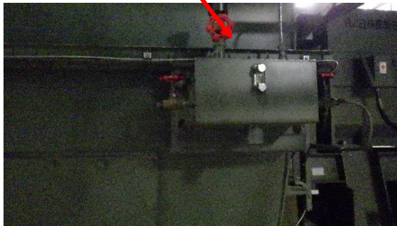
(写真 3 - 2) 排風機 (B) のリザーブタンク (潤滑油補給タンク) の状況
