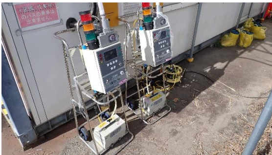
(写真5-2) ・作業エリア内のダスト濃度を測定しているダストモニタ (写真左)。 ・作業エリア境界の南側のダスト濃度を測定しているダストモニタ (写真右)。 ※ 高温焼却炉建屋南側に設置
