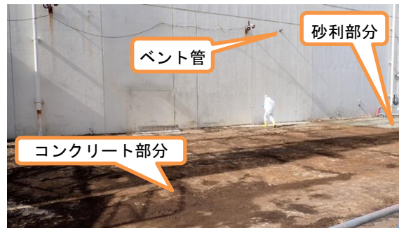
(写真 2 - 2) 高温焼却炉建屋東側地面の状況(2月9日撮影)
