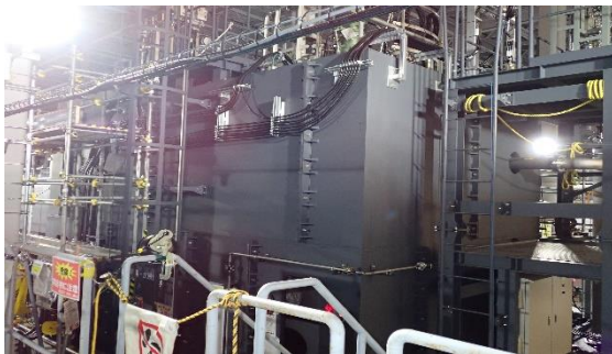
(写真6-2) 増設ALPS (A系) の前処理設備 改造工事の状況② (北西側から撮影)
