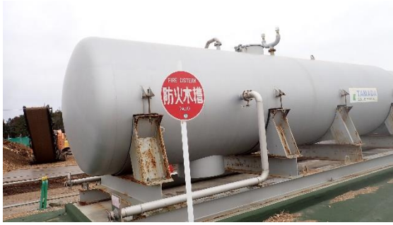
(写真4-1) 防火水槽の設置状況
