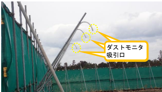
(写真 3 - 2) ダストモニタ吸引口の設置状況
