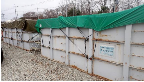
(写真6) 消火用タンクの設置状況
