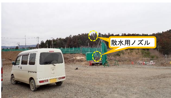
(写真 3 - 3) 散水用ノズルの設置状況
