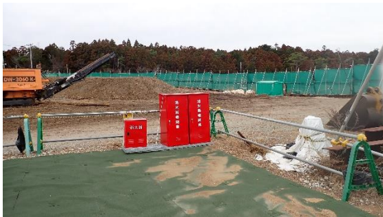
(写真4-2) 消火器の設置状況
