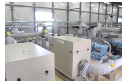
処理水移送ポンプ 出口放射線モニタ
