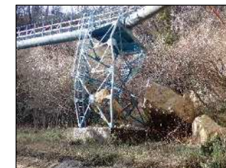
【復旧前】 （管路・橋脚が破損）
