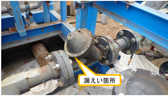
(写真 2 - 2) 交換前の弁の状況 (漏えいがあった 弁と同じタイプ)
