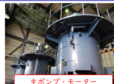
主ポンプ・モーター
