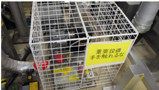
(写真1-5) ダストモニタ吸引ポンプ
