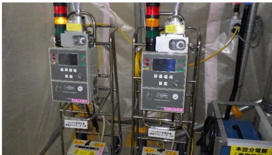
(写真3-3) ダストモニタ（仮設局所排気設備）
