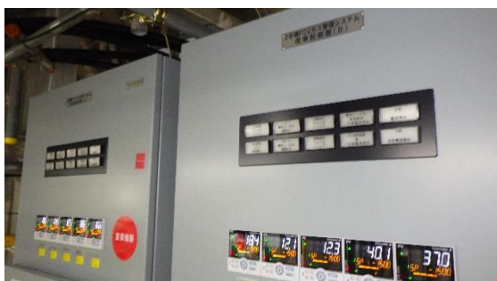
(写真1-2) PCVガス管理設備現場制御盤
