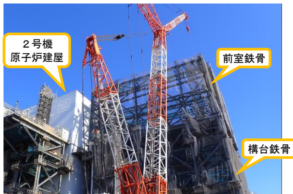
(写真2) 2号機原子炉建屋南側ヤードの状況 (西側から撮影)
