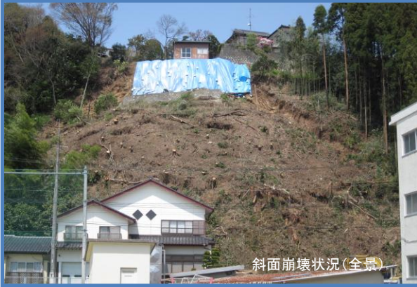
工事着手前(斜面崩落状況)
