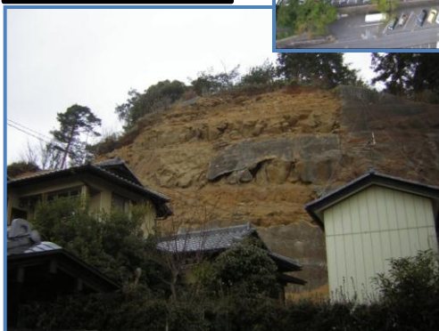
工事着手前 (斜面崩落状況)
