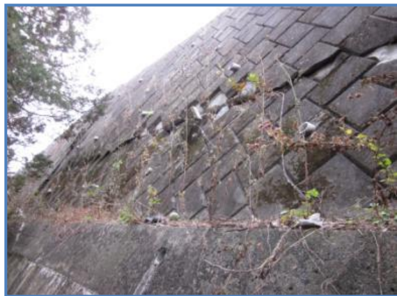
工事着手前(擁壁被災状況)
