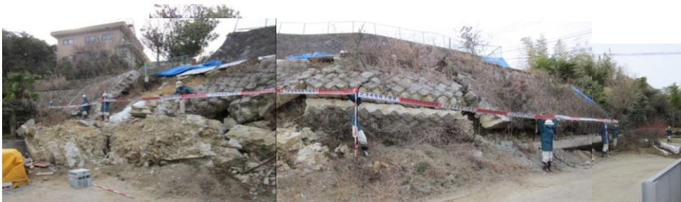
工事着手前(擁壁被災状況)
