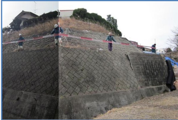
工事着手前(擁壁被災状況)
