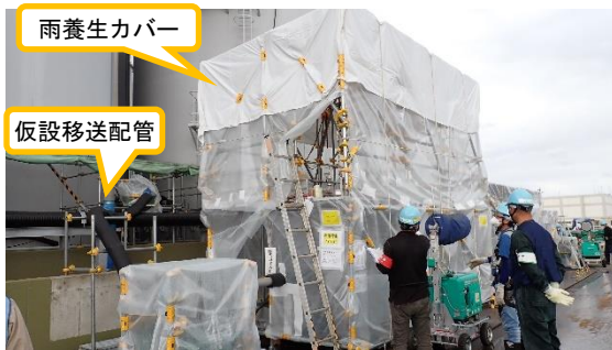
(写真1-1) K4タンクエリア南側仮設移送設備 における仮設移送配管及び雨養生カ バーの設置状況 (令和5年11月7日撮影)
