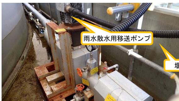
(写真5-2) 雨水回収タンク J 1 の雨水散水用移送ポンプの状況
