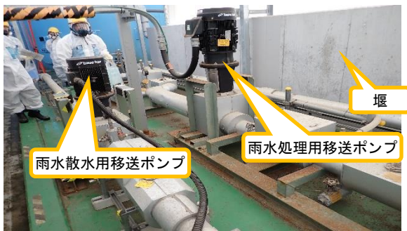
(写真5-5) 雨水回収タンクBの雨水散水用移送ポンプ及び雨水処理用移送ポンプの状況
