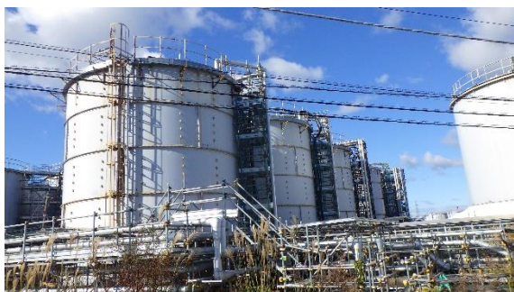
(写真4-1) 雨水受入タンク及び雨水処理水タンクの外観（南東側から撮影）
