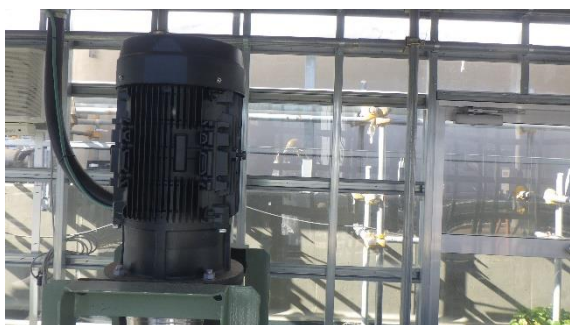
(写真5-3) 雨水回収タンク J 1 の雨水処理用移送ポンプの状況
