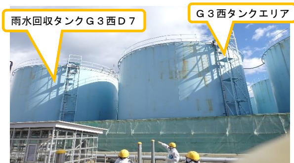
(写真6-1) 雨水回収タンクG3西D7の外観 (南西側から撮影)
