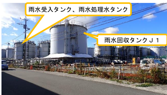
(写真5-1) 雨水回収タンク J 1 の外観 （北東側から撮影）
