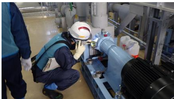
(写真 2 - 2) 処理水移送ポンプ (A) 起動後の確認状況
