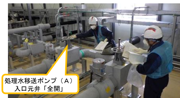
（写真2-1） 処理水移送ポンプ（A）入口元弁 「全開」の確認状況
