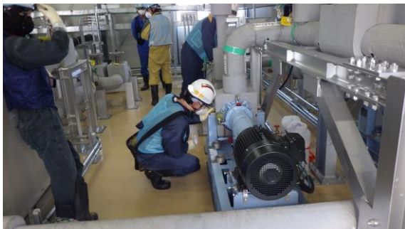
(写真2) ALPS処理水移送ポンプの確認状況
