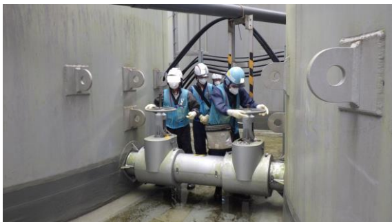
(写真1) 連結弁の「全開」操作の状況
