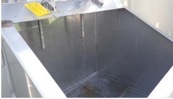
(写真3) 試料採取設備の状況 (写真撮影時はフラッシング中)
