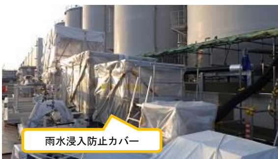
(写真6) ホース、ポンプ及びフィルタ等の設置状況 (ポンプ及びフィルタ等は、雨水浸入防止カバーで覆われている)
