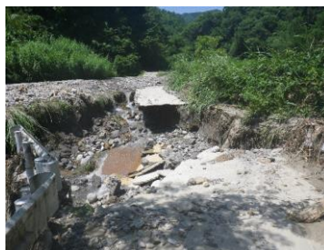
▼林道被害 洲谷線(喜多方市)
