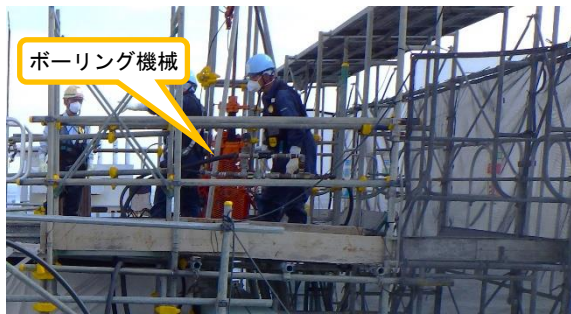
(写真 1 - 3) 試験施工位置 1 - 1 におけるボーリング機械の設置状況 (6号機タービン建屋屋上)
