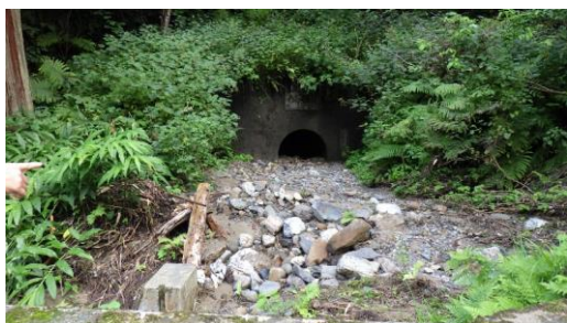
▲大林堰 土砂流入状況
