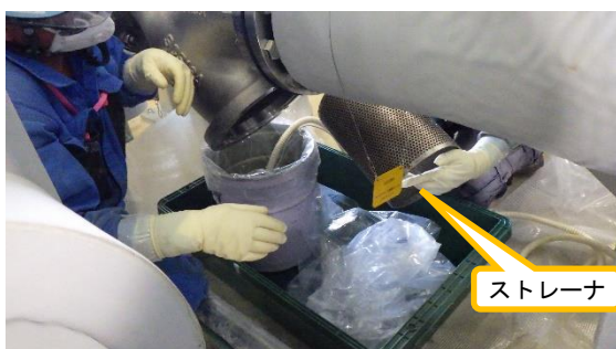
(写真2) ストレーナの交換状況 (サンプルタンク循環ポンプ側)
