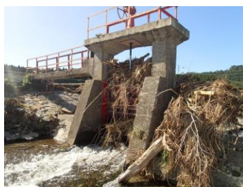
▲ 取水口への土砂・流木堆積(神田壠)
