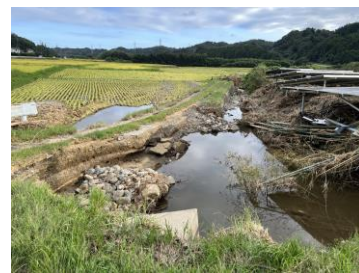
▲ 農道の崩落(藤原川周辺)
