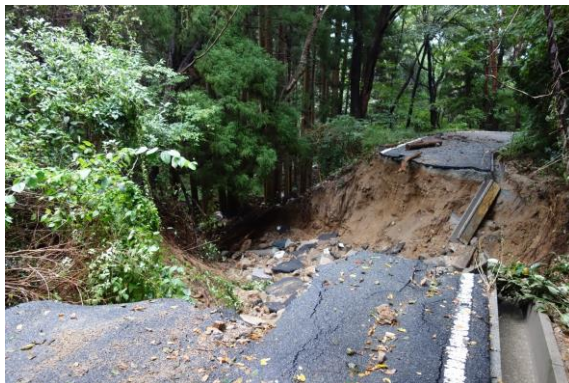
▲ 林道檜石線の路面崩落 (小川地区)
