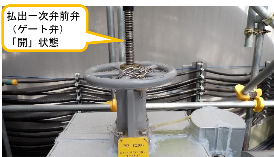
(写真2-2) 払出一次弁前弁 (ゲート弁) 「開」 状態
