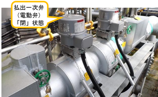
(写真 2 - 4) 払出一次弁 (電動弁) 「閉」状態 (全景)
