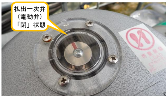
(写真 2 - 5) 払出一次弁 (電動弁) 「閉」状態 (近景)
