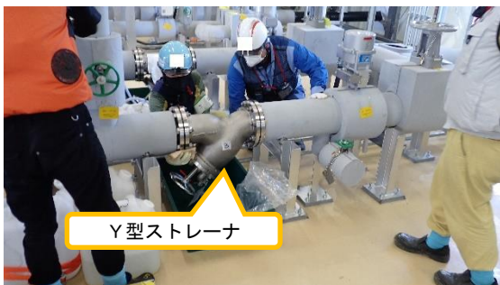
(写真2) Y型ストレーナ周囲の水漏れ確認の状況
