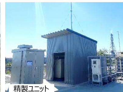
精製ユニット
