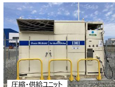
圧縮・供給ユニット
