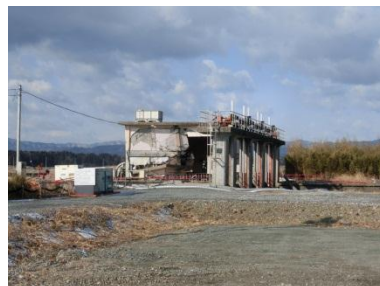
津波で被災した建物
