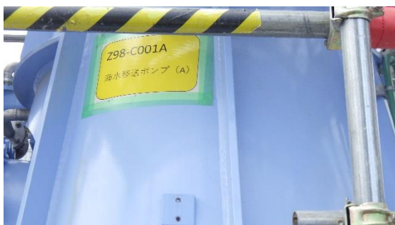
(写真4-1) 海水移送ポンプ (A) の状況
