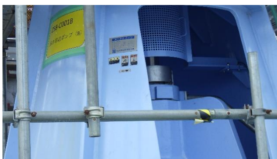
(写真4-2) 海水移送ポンプ (B) の状況
