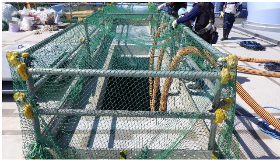
(写真3-2) 放水立坑（上流水槽）の蓋開口部 （西側）に水中ポンプと耐圧ホース の設置が完了した状況
