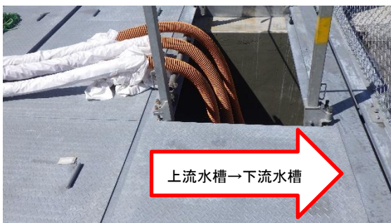
(写真2-2) 上流水槽と下流水槽の接続部上部の蓋開口部（西側）の状況（※左の耐圧ホースは写真3-2の耐圧ホースにつながっている。）
