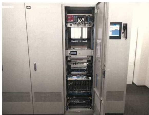
【ダム管理用制御処理設備】
