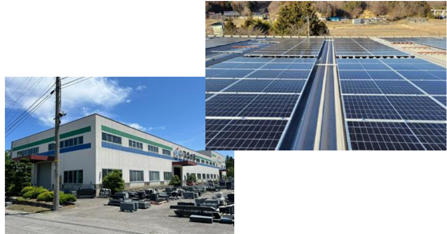
（株）フクイシの工場に設置された太陽光発電設備
