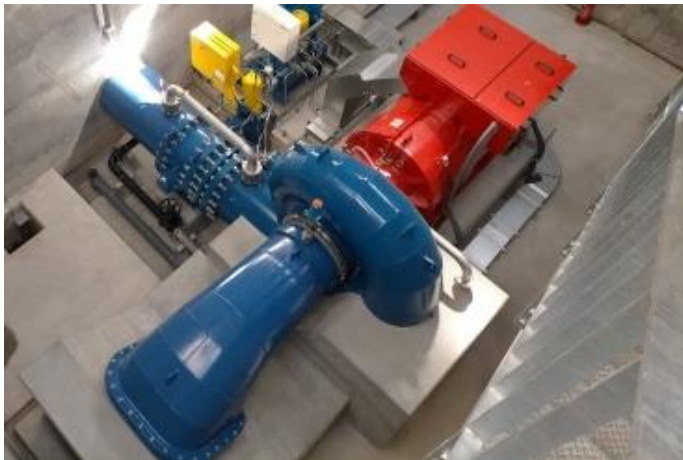
信夫山・光大寺小水力発電所（R4補助事業） 水車発電機
