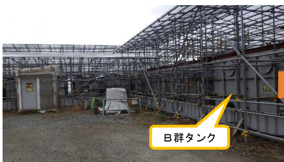
(写真2-1) F2タンクエリア B群タンクの状況 (北側から確認) (撮影日: 令和元年12月17日)
