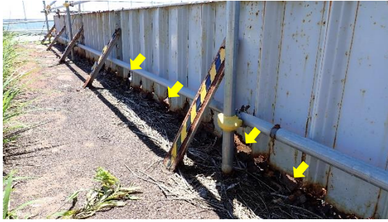
(写真3) F2タンクエリア A群タンク北側の堰貫通穴の状況 (黄矢印)
