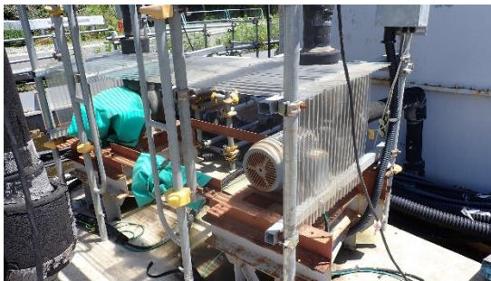
(写真4-2) F2タンクエリアC群タンク移送ポンプ
