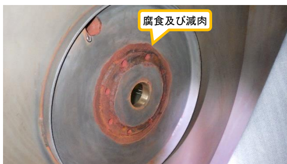
(写真2) 排ガス補助ブロアケーシングの腐食及び減肉の状況
