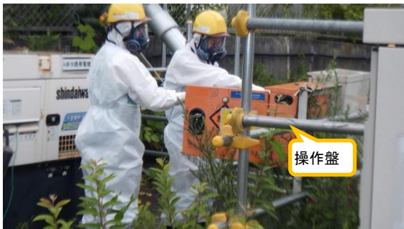
(写真2-1) A排水路移送訓練の状況 (ポンプ起動模擬訓練)
