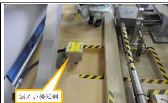
(写真2) 多核種移送設備建屋における漏えい検知器の設置状況
