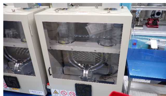
(写真2-2) 電解濃縮装置の状況
