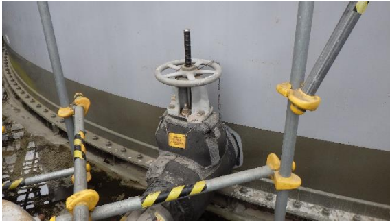
(写真 3 - 3) 堰内の弁の一例
