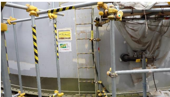
(写真3-1) 既設ALPSサンプルタンクの一例
