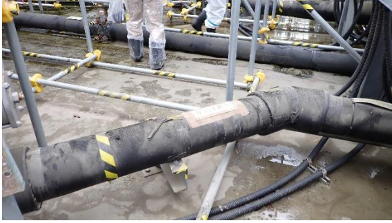
(写真 3 - 2) 堰内の配管の一例
