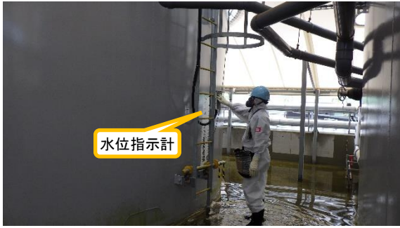
(写真 5 - 1) 雨水処理水タンク B の水位確認状況
