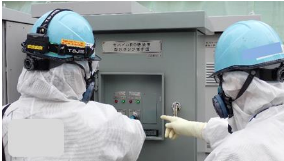
(写真 5 - 2) 散水ポンプ電源投入の状況
