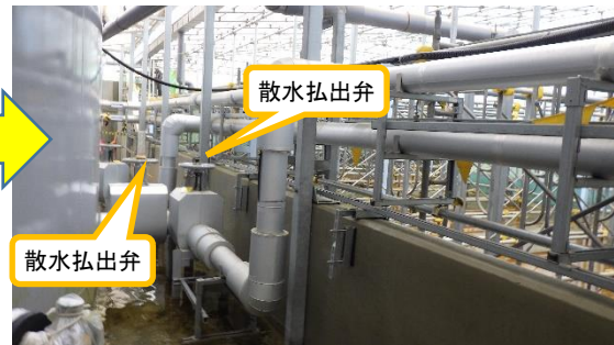
(写真 2 - 2) 雨水処理水タンク A の散水払出弁の 状況 (今回(令和5年6月12日)東側か ら撮影)
