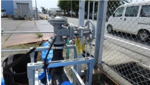
(写真1) ALPS 処理水移送配管ベント弁
