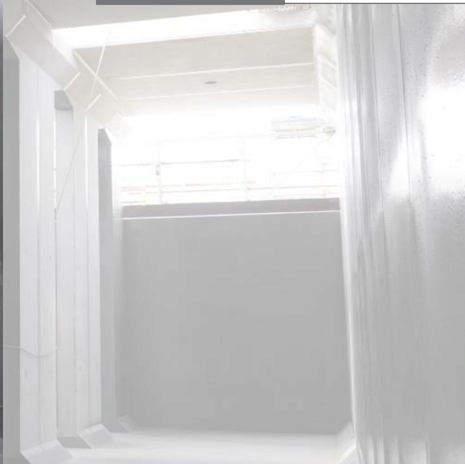
上流水槽 (ALPS処理水希釈放出設備)
